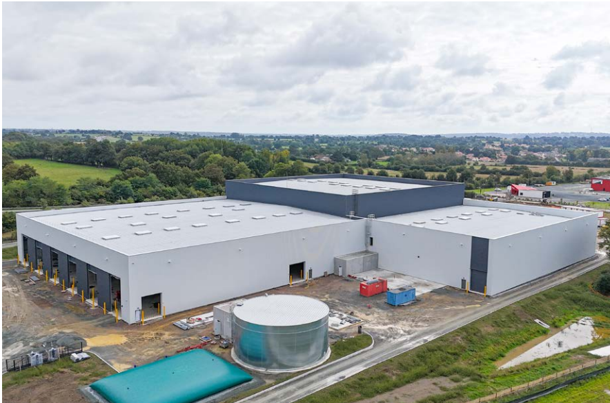
Hall de réception à gauche, hall d'expédition à droite, cuve et réserve d'eau extérieure
